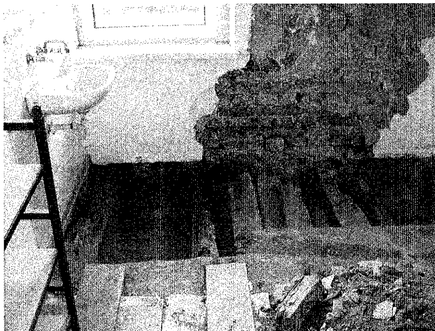
Uszkodzone belki stropu nad parterem - wymagana wymiana na nowe
