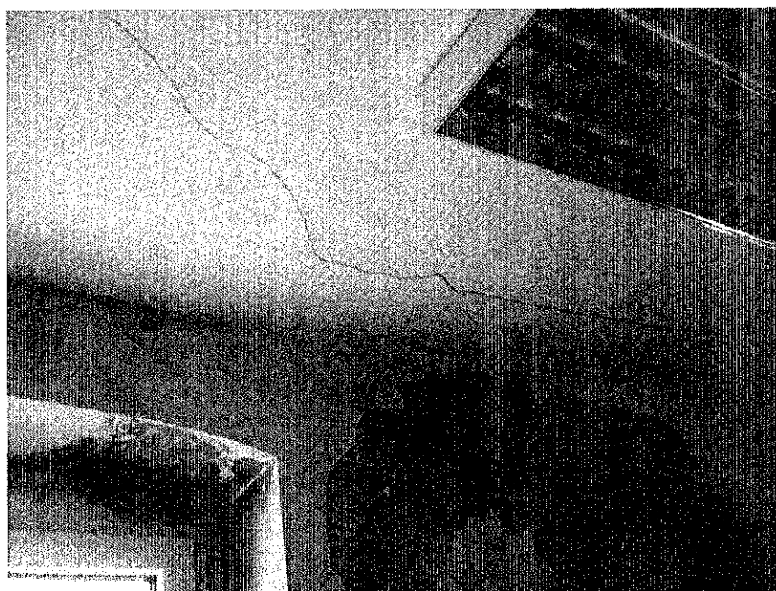
Uszkodzone belki stropu nad 1-pietrem - wymagane wzmocnienie końcówek belek
