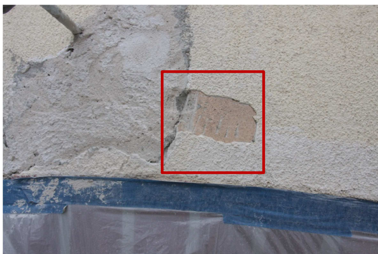
Odkrywka nr 5 ukazuje wtórny tynk pokryty również farbą w kolorze beżowym.
