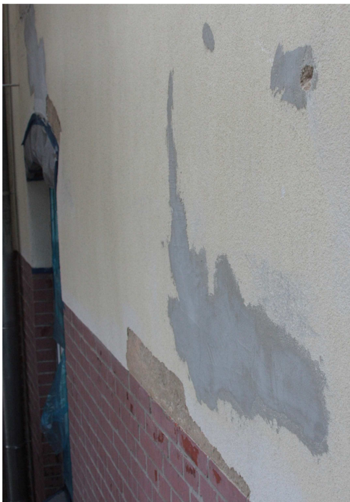
Fot. 6. Budynek należących do zespołu dawnych koszar piechoty przy ul. Artyleryjskiej 3b w Olsztynie, elewacja zachodnia część centralna. Widoczne naprawy wierzchnie oraz lokalnie odsłonięty tynk pierwotny.
