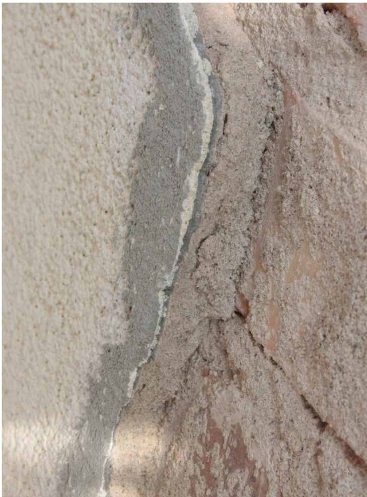
Fot. 5. Budynek należących do zespołu dawnych koszar piechoty przy ul. Artyleryjskiej 3b w Olsztynie, elewacja zachodnia część południowa, przekór przez warstwy tynków. Widoczne rozwarstwienia w tynku pierwotnym, słaba adhezja do podłoża.
