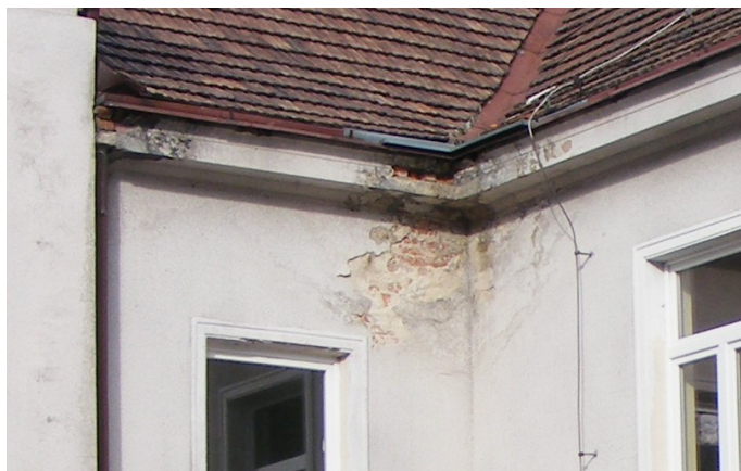
Zdj. 2 – widoczne zacieki
