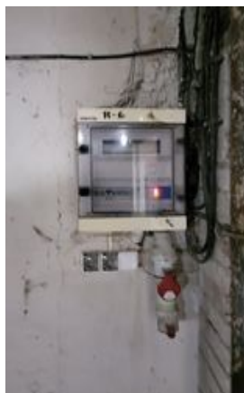
Foto 10. Tablica rozdzielcza w budynku Magazynowym – Zadanie Nr 3
