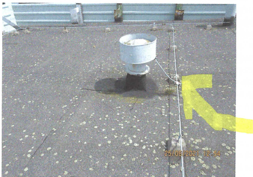
Fot.7. Instalacja odgromowa – ślady korozji złączy krzyżowych
