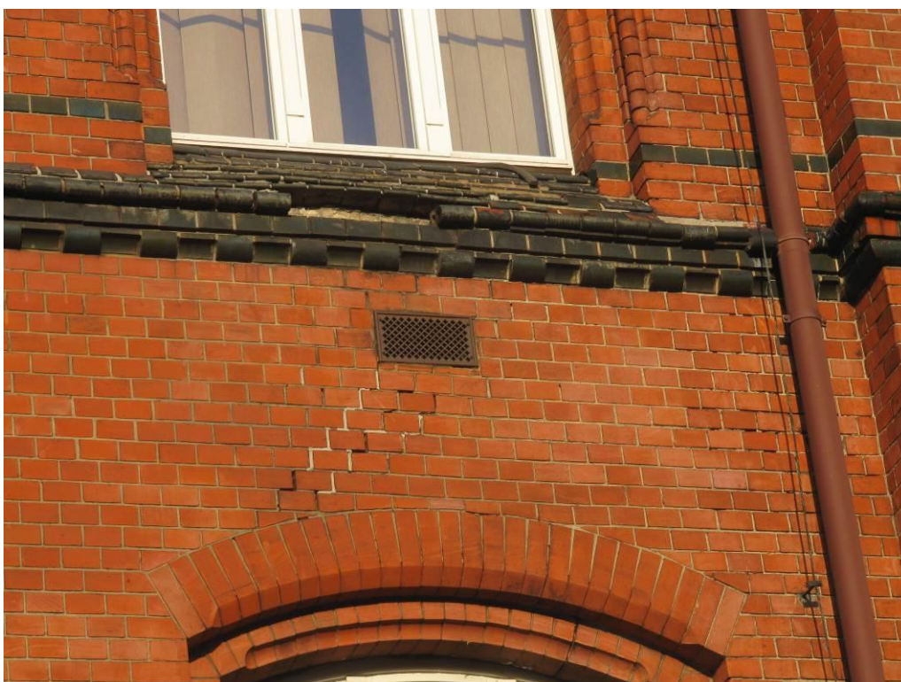
Fot. 13. Lokalne ubytki kształtek glazurowanych przy parapetach okiennych i rozwarstwienia przebiegające wzdłuż spoin
