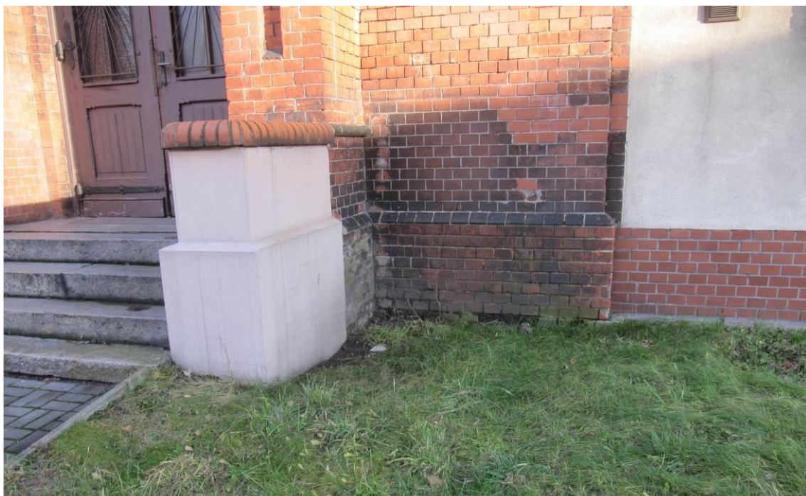
Fot. 15. Przykładowe zawilgocenia murów przy styku z terenem
