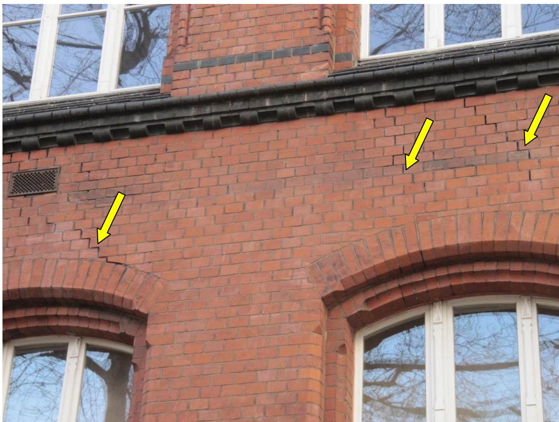
Fot. 14. Przykładowe ukośne rozwarstwienia murów wzdłuż spoin
