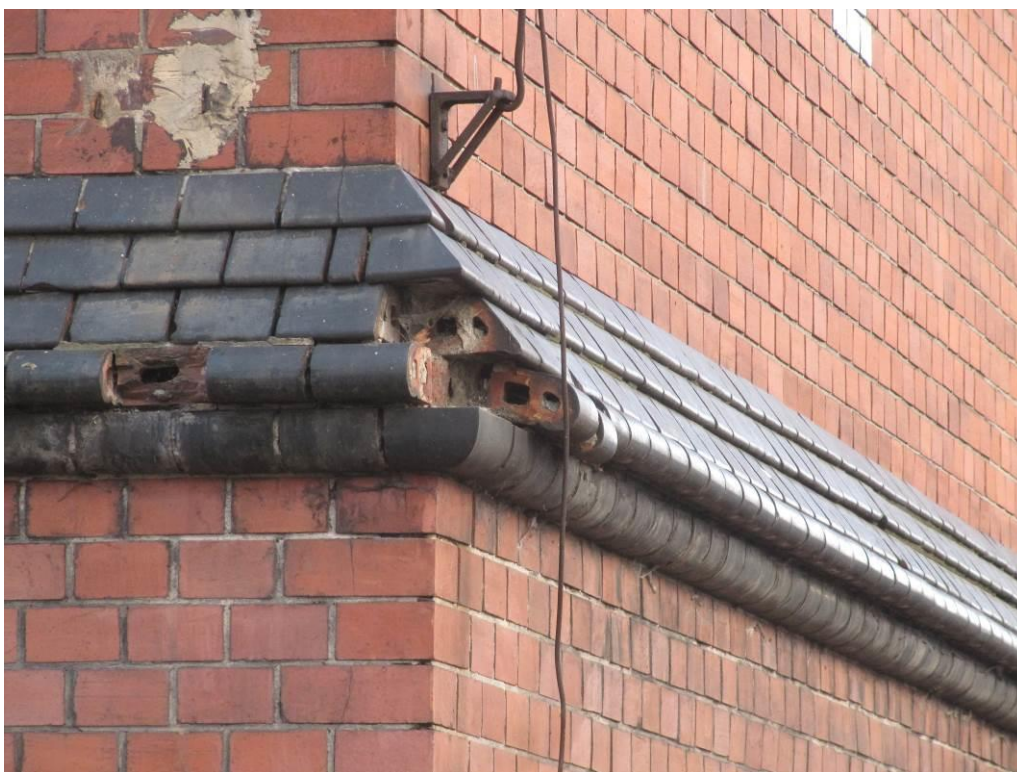
Fot. 12. Lokalne ubytki kształtek glazurowanych na gzymsie cokołowym
