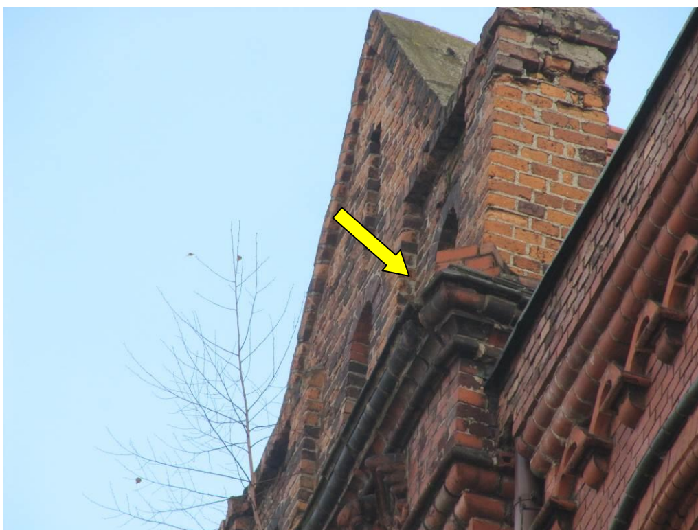
Fot. 10. Szczyt wieńczący ryzalit elewacji północnej, samosiejka wyrastająca z gzymsu wieńczącego i odspojony narożnik gzymsu
