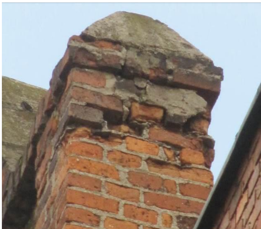
Fot. 11. Szczyt wieńczący ryzalit elewacji północnej; ubytki i rozluźnienia elementów murtwych
