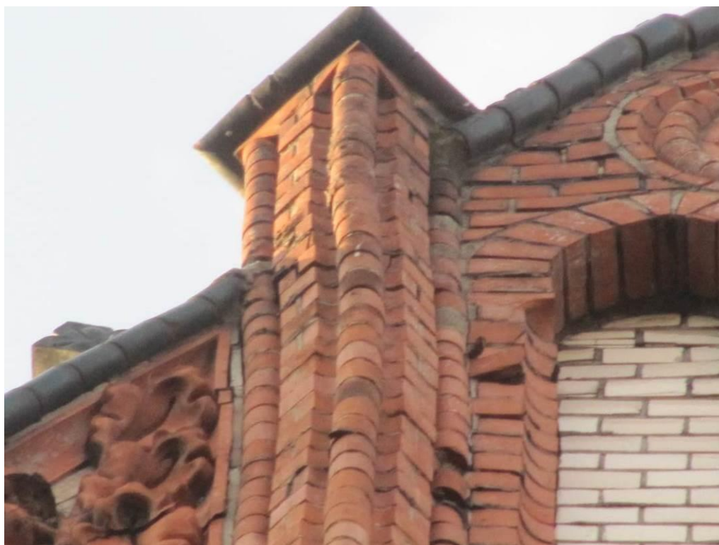
Fot. 5. Górny fragment szczytu wieńczącego ryzalit fasady; deformacje pilastra, niestabilne elementy murowe
