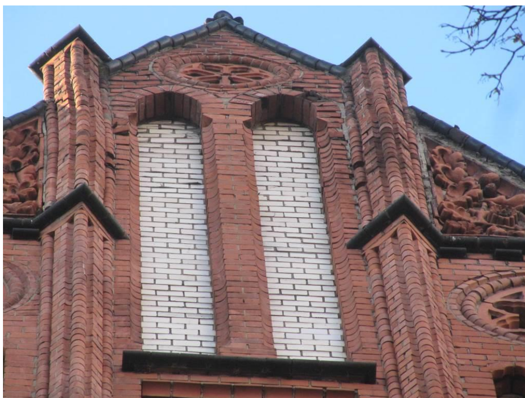
Fot. 2. Górny fragment szczytu wieńczącego ryzalit fasady – widoczne ubytki elementów murowych i deformacje pilastrów
