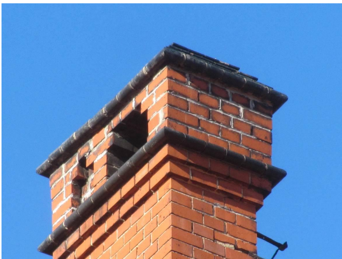
Fot. 16. Stan murów kominowych
