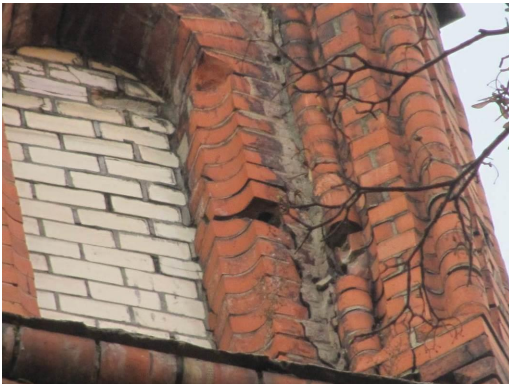
Fot. 4. Górny fragment szczytu wieńczącego ryzalit fasady – widoczne ubytki elementów murowych, odspojenia zapraw ze starych napraw
