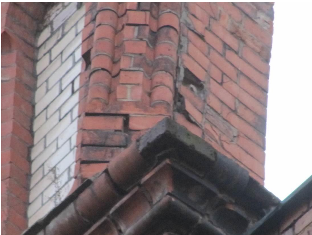
Fot. 3. Górny fragment szczytu wieńczącego ryzalit fasady – widoczne ubytki elementów murowych, deformacje pilastrów, odspojenie naroża gzymsu
