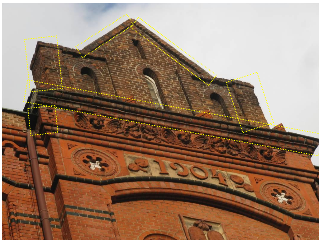
Fot. 7. Szczyt wieńczący ryzalit elewacji południowej – strefy największych uszkodzeń
