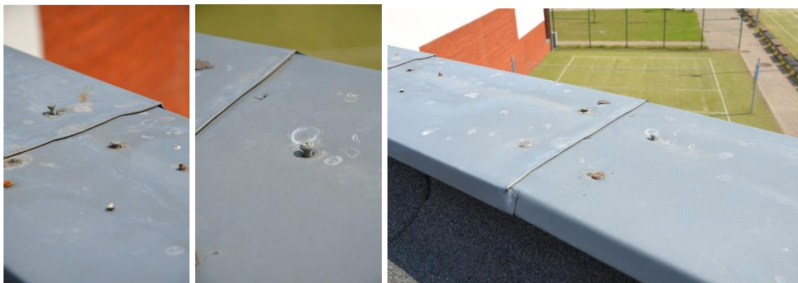
Fot.52-54. Brak szczelności w montażu opierzeń.
