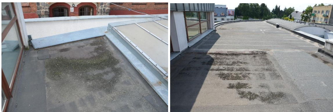
Fot.32,33. Ślady po zastoiskach wody na dachu
