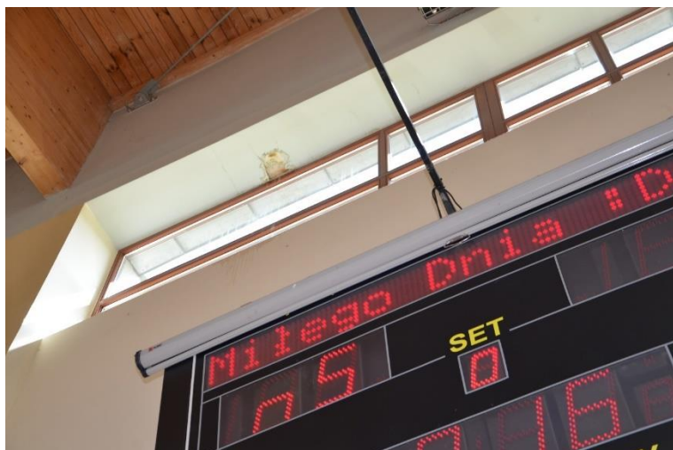
Fot.25. Sala sportowa – ślady zacieków w sąsiedztwie nadproża okiennego.
