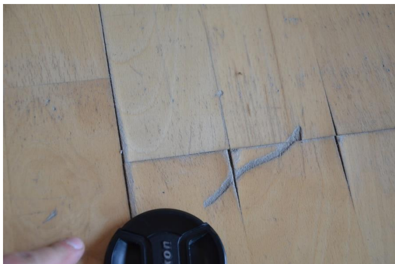
Fot.23. Drewniana posadzka hali sportowej - widoczne szczeliny pomiędzy elementami drewnianymi.
