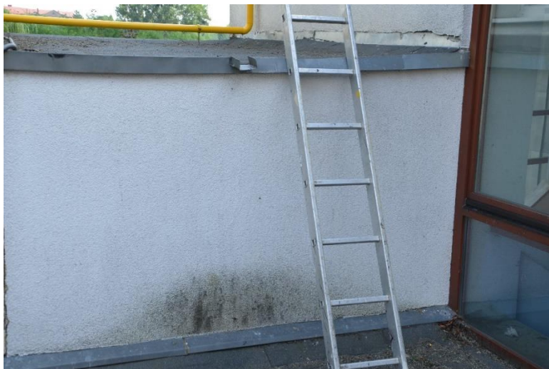
Fot.87. Widok zawilgocenia ściany.
