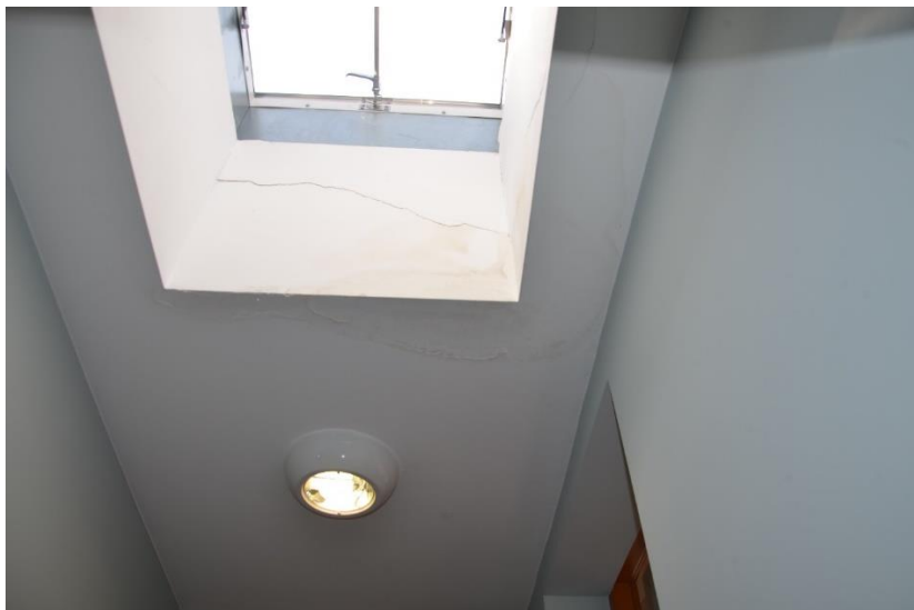
Fot.11. Ślady zacieków w rejonie wnęki na świetlik dachowy.
