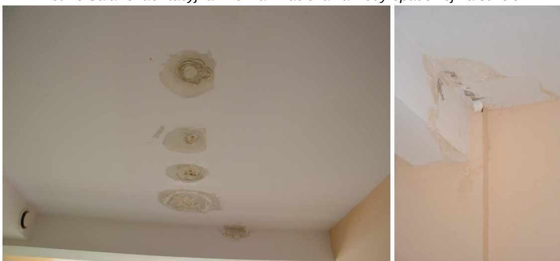
Fot.14,15. Część rekreacyjna – ślady zacieków na suficie.
