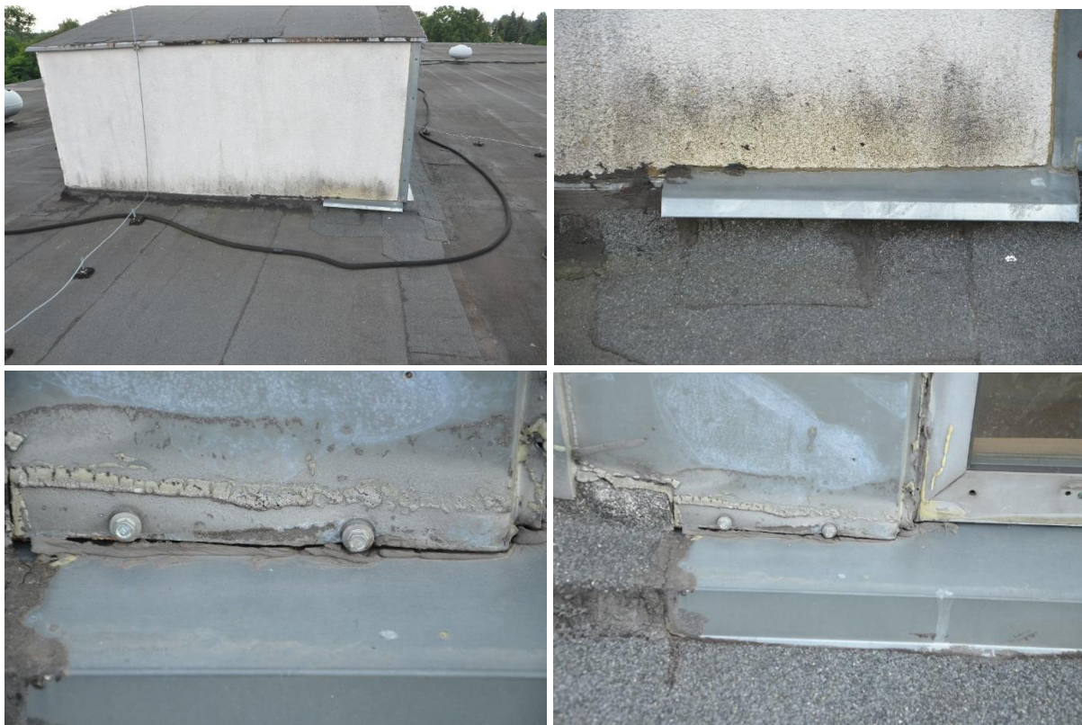
Fot.89-92. Widok zawilgocenia ścian, prowizoryczny montaż obróbek blacharskich, nieszczelne połączenia obróbek ze ścianą.
