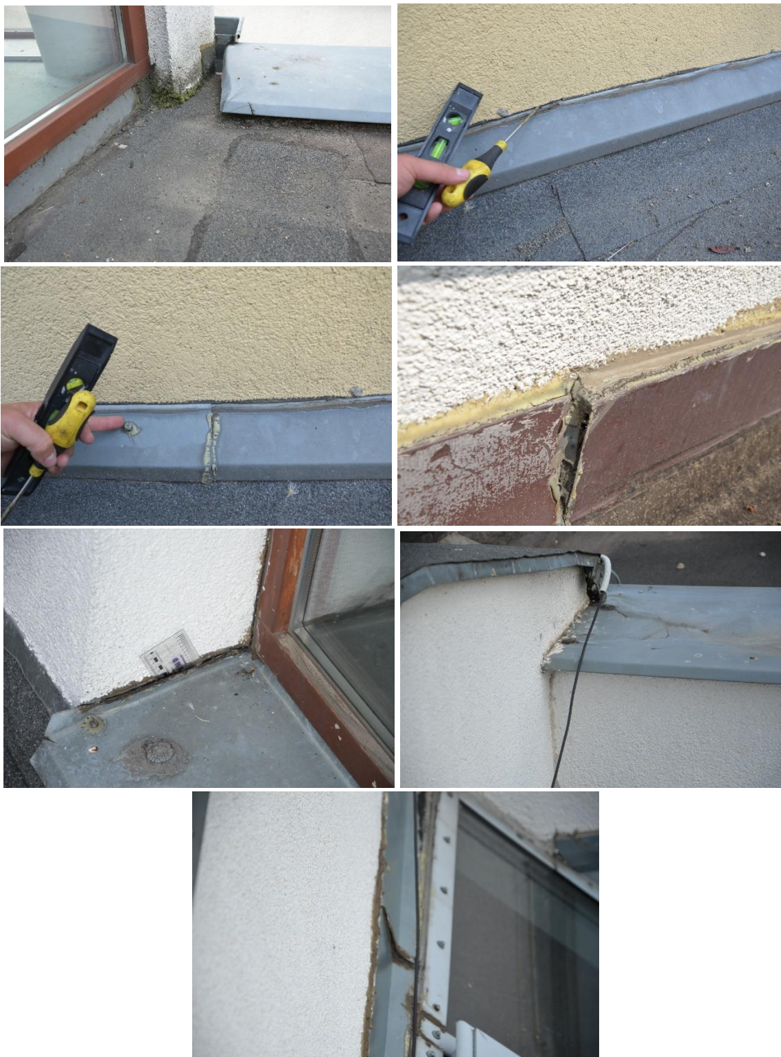
Fot.55-60. Brak szczelności w montażu opierzeni z elewacją ścian oraz attyką dachu.
