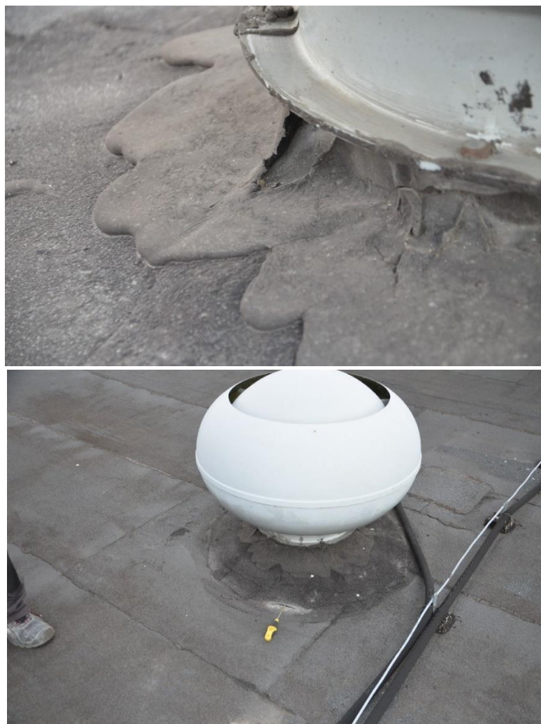
Fot.81-82. Nieszczelność poszycia dachowego wokół wentylatorów.
