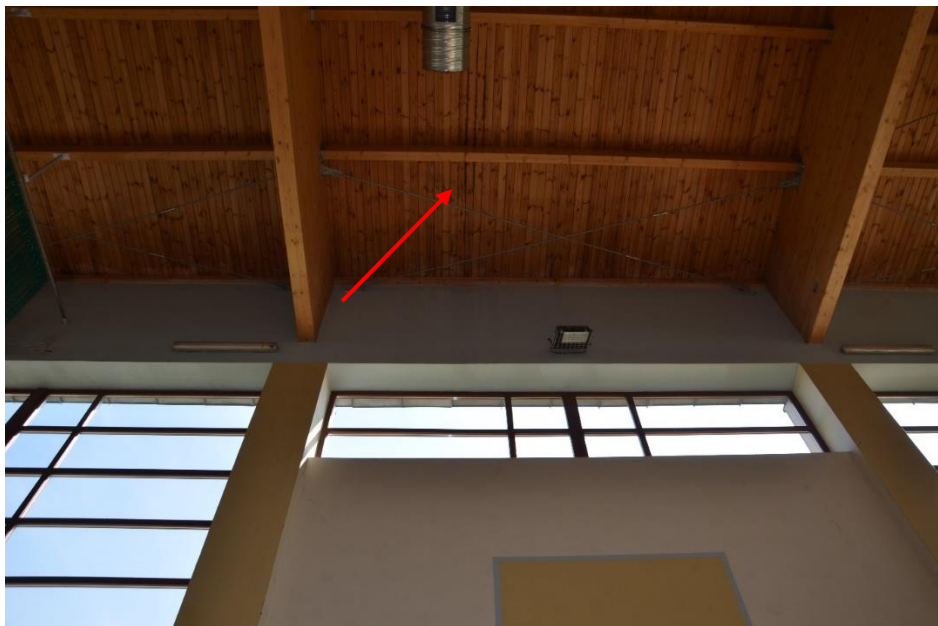
Fot.24. Dach sali sportowej- ślady przecieków.
