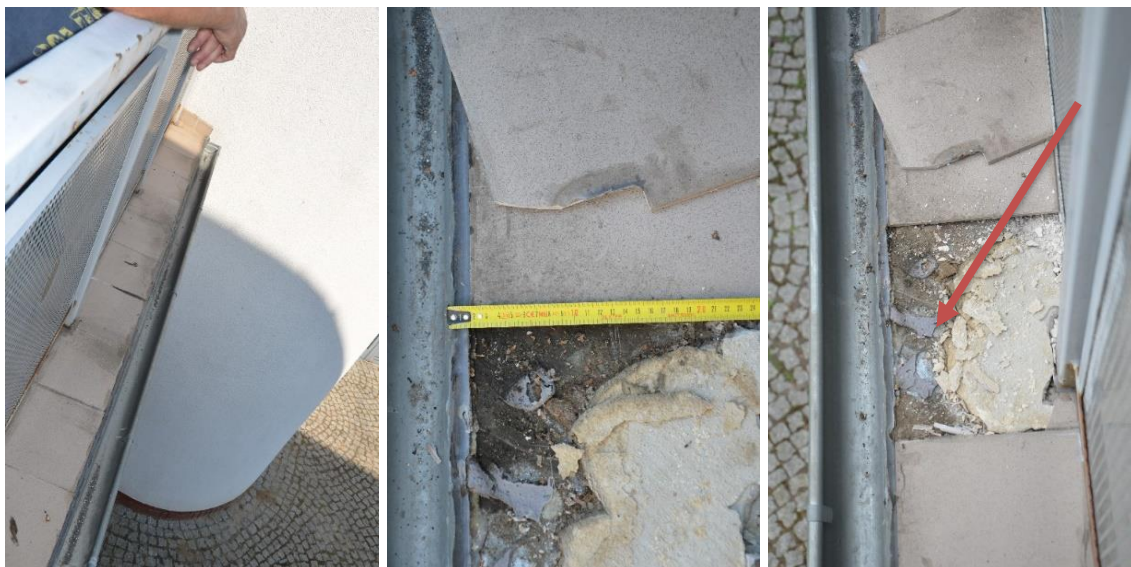
Fot.27-29. Widok krawędzi tarasu i wykonanej odkrywki. Zaznaczono widoczną krawędź obróbki blacharskiej.
