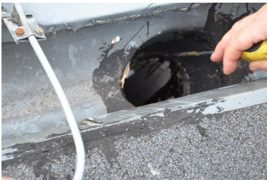
Fot.97. Widok na połączenie rury spustowej z rynną.
