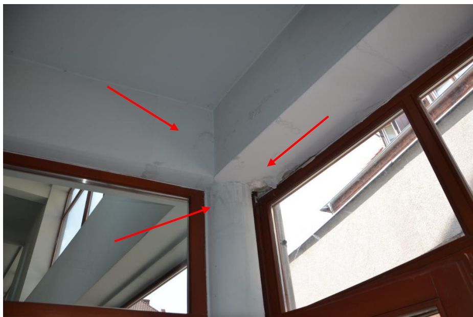
Fot.8. Oznaki zaciekania wody opadowej w sąsiedztwie nadproża okiennego.
