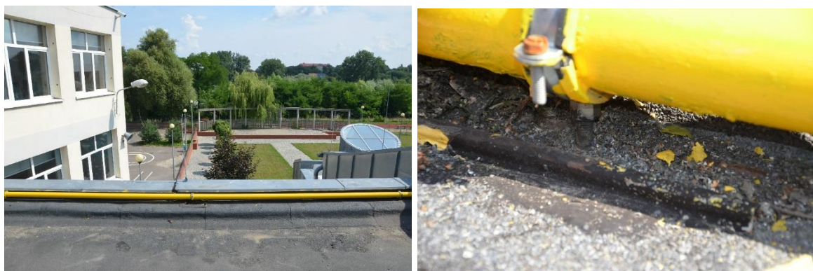
Fot.79-80. Montaż instalacji gazowej niezapewniający szczelności poszycia.
