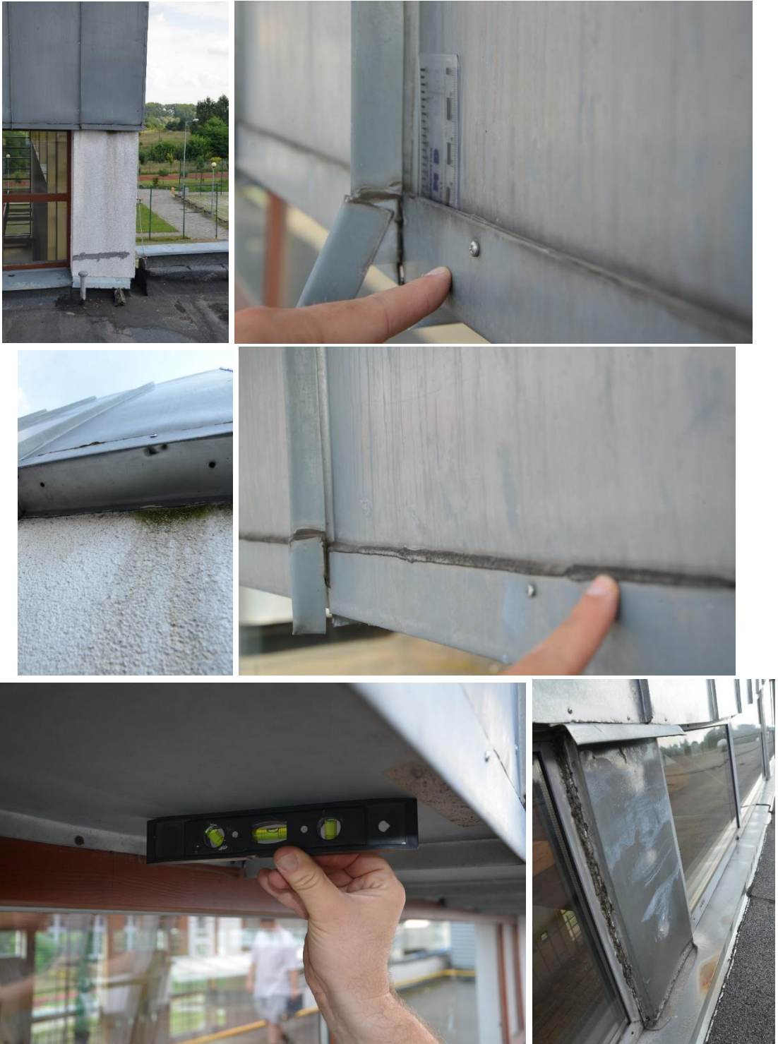
Fot.61-66 Nieszczelności w montażu elementów z blachy naświetla.
