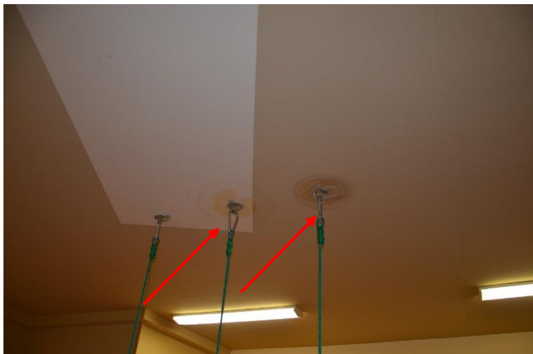
Fot.13. Sala rehabilitacyjna – oznaki zaciekania wody opadowej na suficie.
