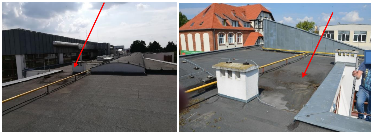
Fot.30,31. Ślady po zastoisku wody - fragment dachu w sąsiedztwie tarasu, (z lewej zdjęcie widok w kierunku południowym, z prawej w północnym).
