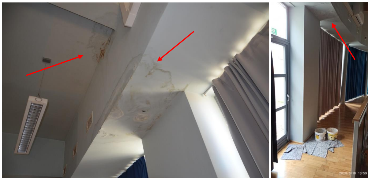
Fot.6,7. Widok na ścianę zewnętrzną - oznaki zaciekania wody opadowej.
