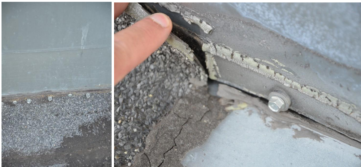
Fot.93-94., nieszczelne połączenia obróbek ze ścianą, przytwierdzenie wywinięcia papy na śruby.
