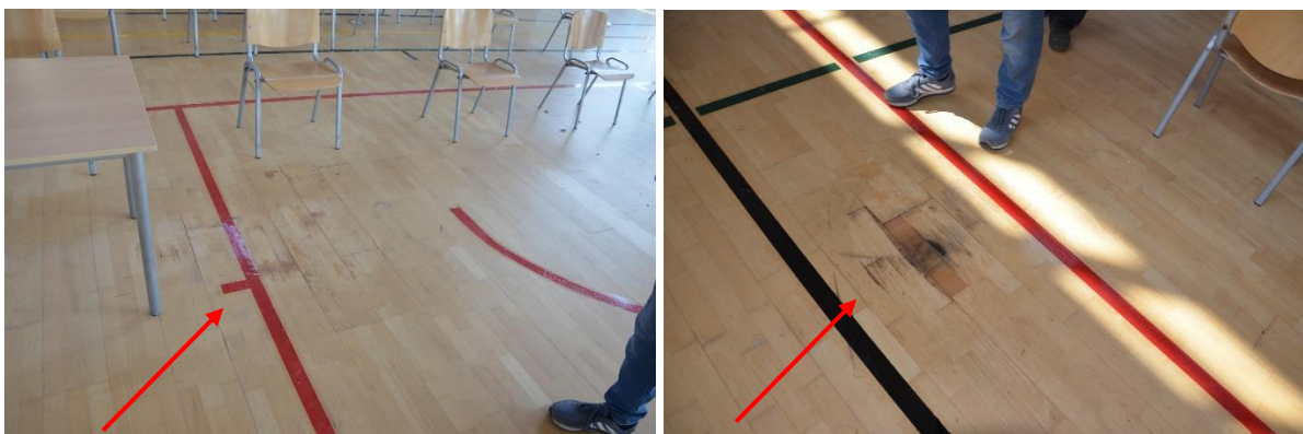
Fot.21,22. Posadzka sali sportowej - przykładowe widoczne zacieki wody opadowej.
