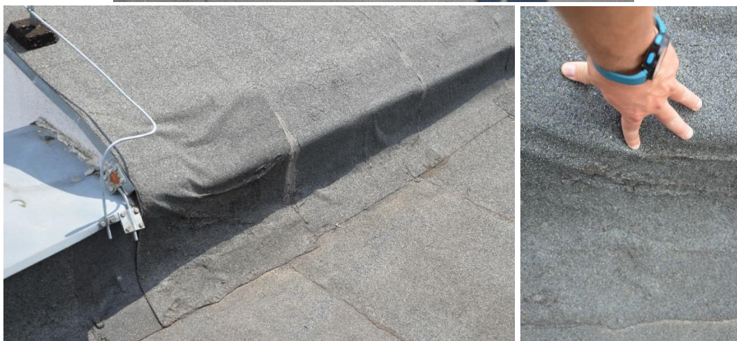
Fot.35-37. Fałdy pokrycia papowego - fragment dachu od strony zachodniej.
