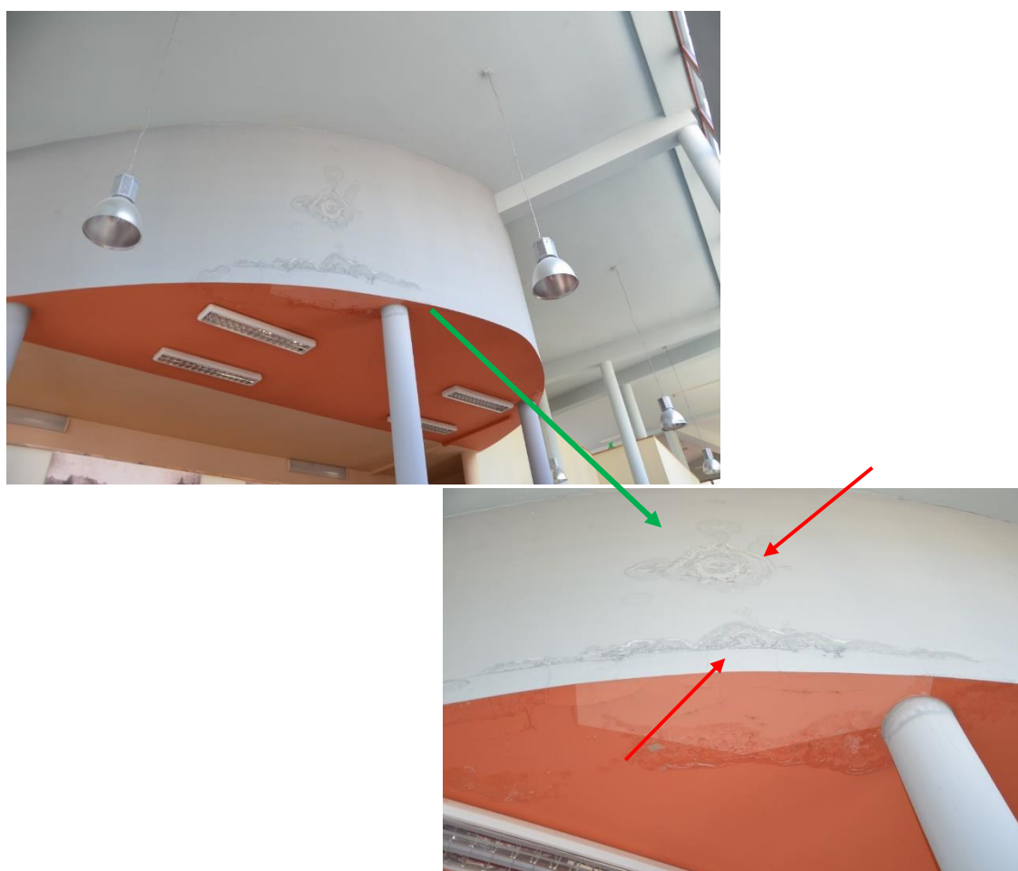
Fot.9,10. Szatnia – widoczne zacieki.
