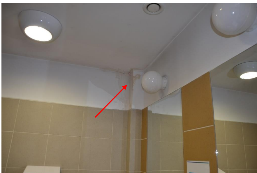
Fot.12. Sanitariat – ślady zacieków wody w sąsiedztwie obudowy pionu instalacyjnego.
