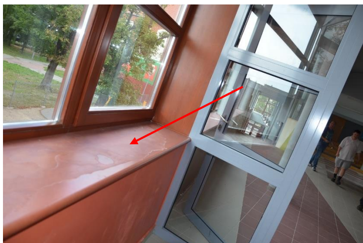
Fot.19. Korytarz na parterze – oznaki zaciekania wody opadowej na parapecie okiennym.
