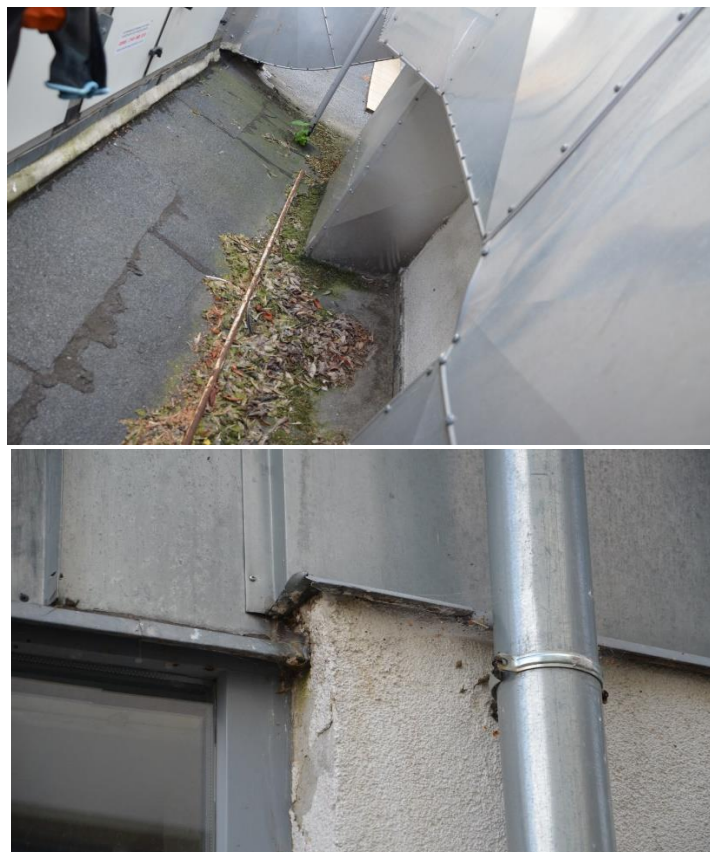
Fot.95-96. Widok defektów na dachu technicznym.
