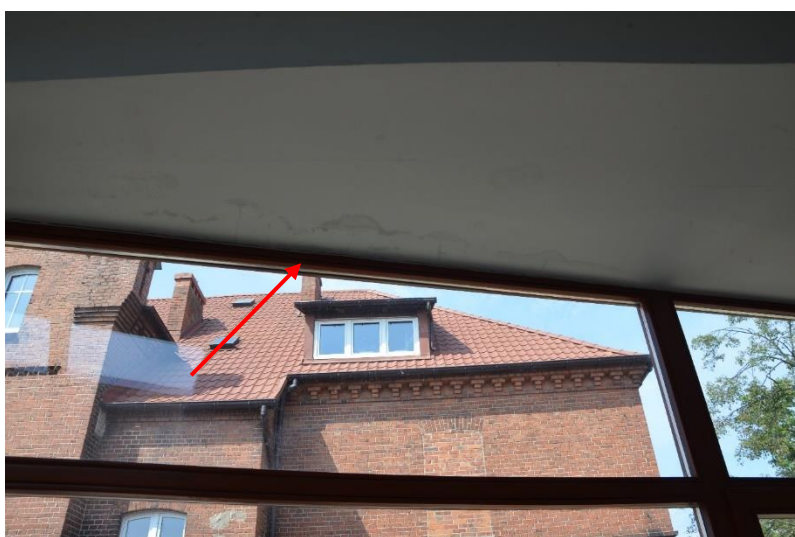
Fot.16. Korytarz – ślady zacieków w styku stolarki okiennej ze stropodachem.
