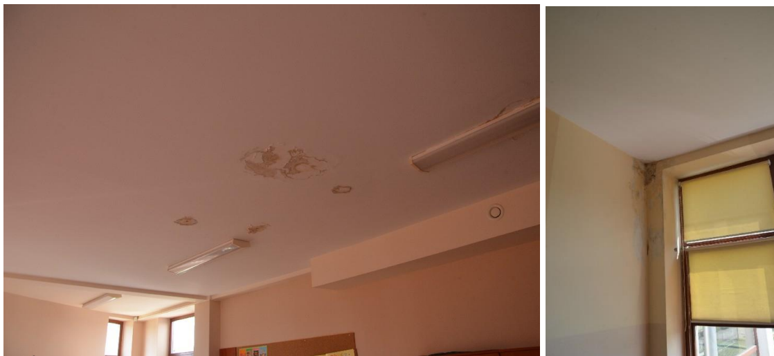
Fot.17,18. Ślady zacieków na suficie, obrębnie lamp oświetleniowych oraz narożach ścian.
