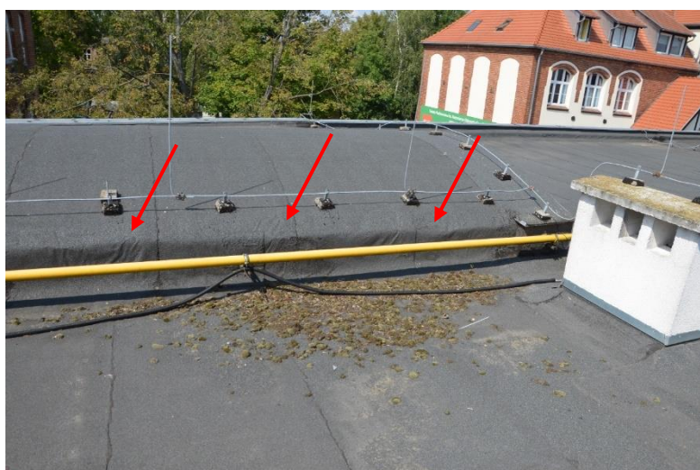
Fot.34. Fałdy pokrycia papowego - fragment dachu w sąsiedztwie tarasu - widok w kierunku zachodnim.
