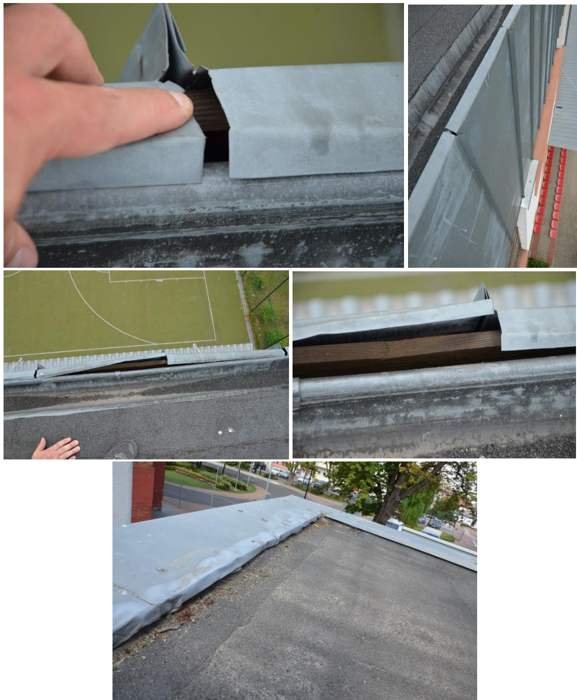
Fot.75-78. Obróbki blacharskie nie zapewniające szczelności połączenia.
