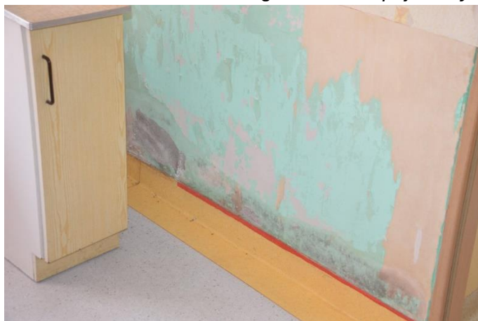
Fot. 27. Przykładowe ślady zawilgocenia ścian (pomieszczenie nr 14 – świetlica).
