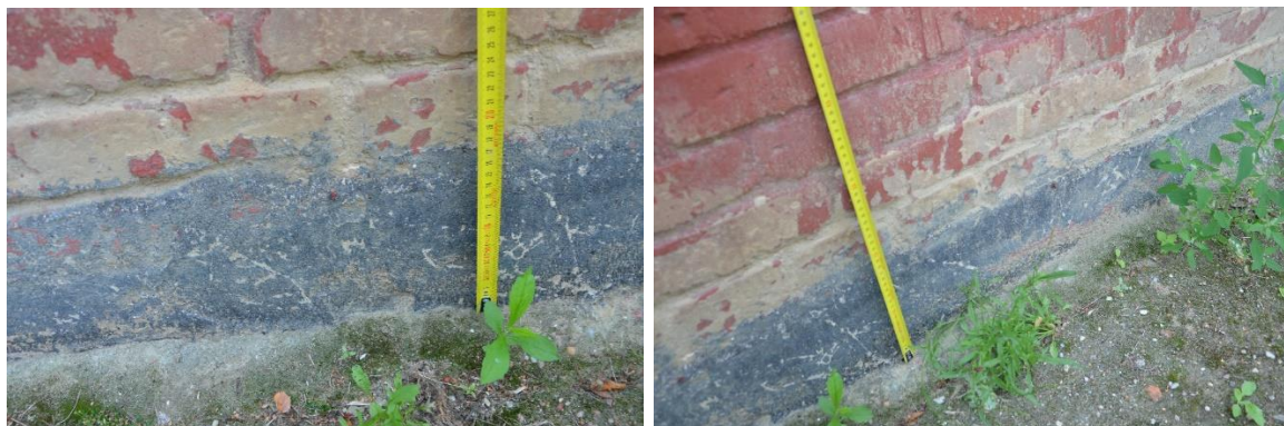
Fot. 40,41. Zabrudzenia ścian oraz złuszczona powłoka malarska.
