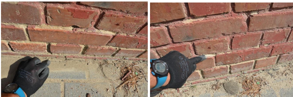
Fot. 11,12. Zniszczenia cegły oraz ubytki spoin w dolnym pasie ścian.
