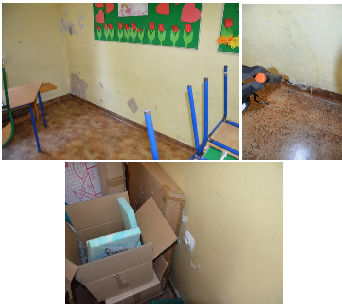
Fot.32-34. Przykładowe ubytki powłok malarskich, odparzenia zawilgoconego tynku.
