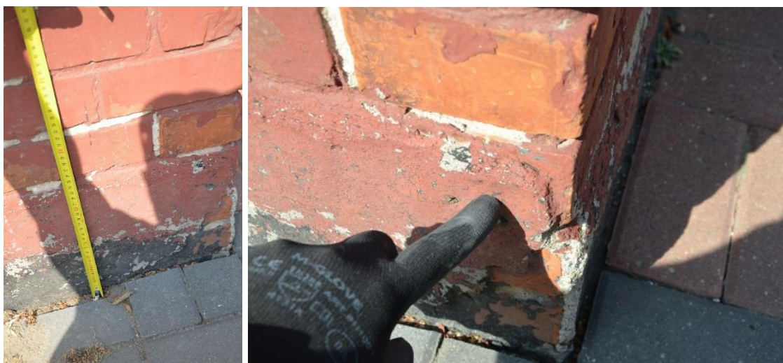
Fot. 15,16. Ślady zewnętrznej izolacji powłokowej.
