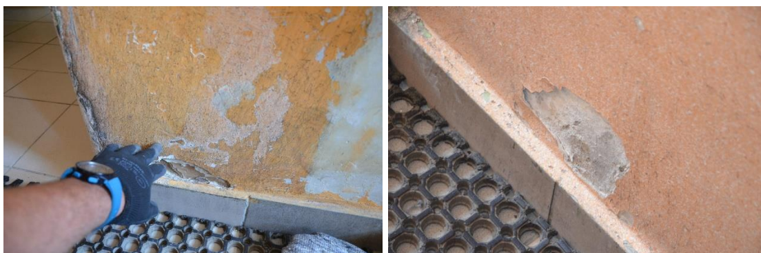
Fot. 25,26. Widok ścian wewnętrznych w sąsiedztwie styku posadzki w strefie wejścia do piwnic – widoczne oznaki zawilgocenia i odspojenia tynku.
