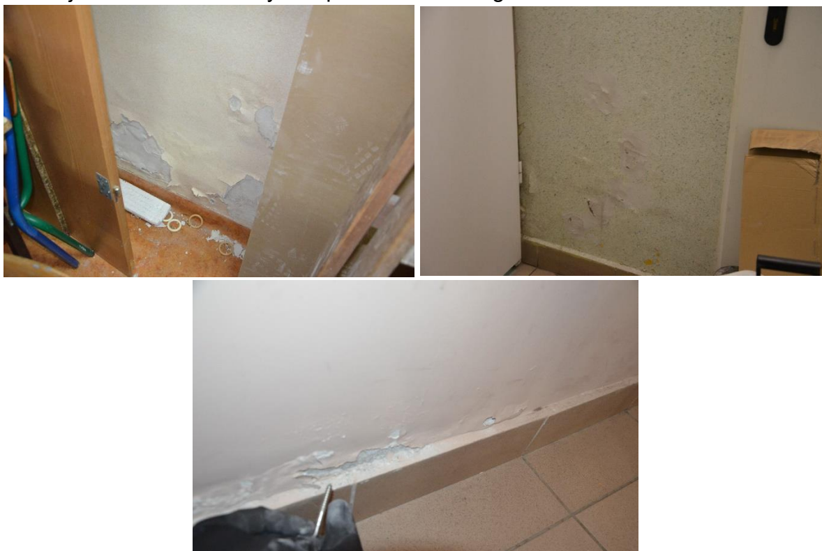
Fot. 51-53. Przykładowe odparzenia zawilgoconego tynku oraz ubytki powłok malarskich.
