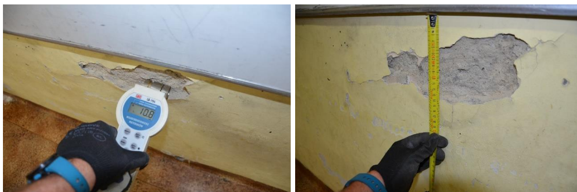
Fot. 28,29. Przykładowe odparzenia zawilgoconego tynku.
