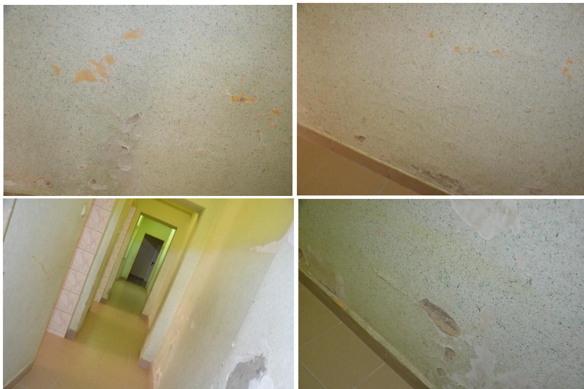
Fot. 47-50. Widok ścian wewnętrznych oraz zewnętrznych w części przy posadzkowej – widoczne oznaki zawilgocenia, odspojenia tynku oraz ubytki farby.
