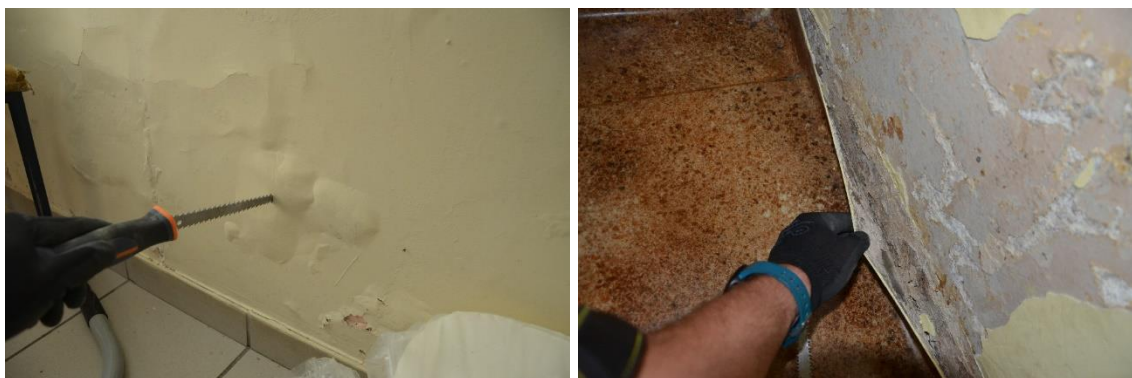
Fot.30-31. Przykładowe ubytki powłok malarskich, odparzenia zawilgoconego tynku.
