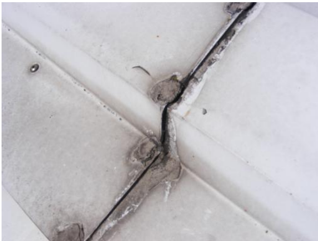
Fot. 1 Obróbka kalenicowa z widocznymi rozszczelnieniami
