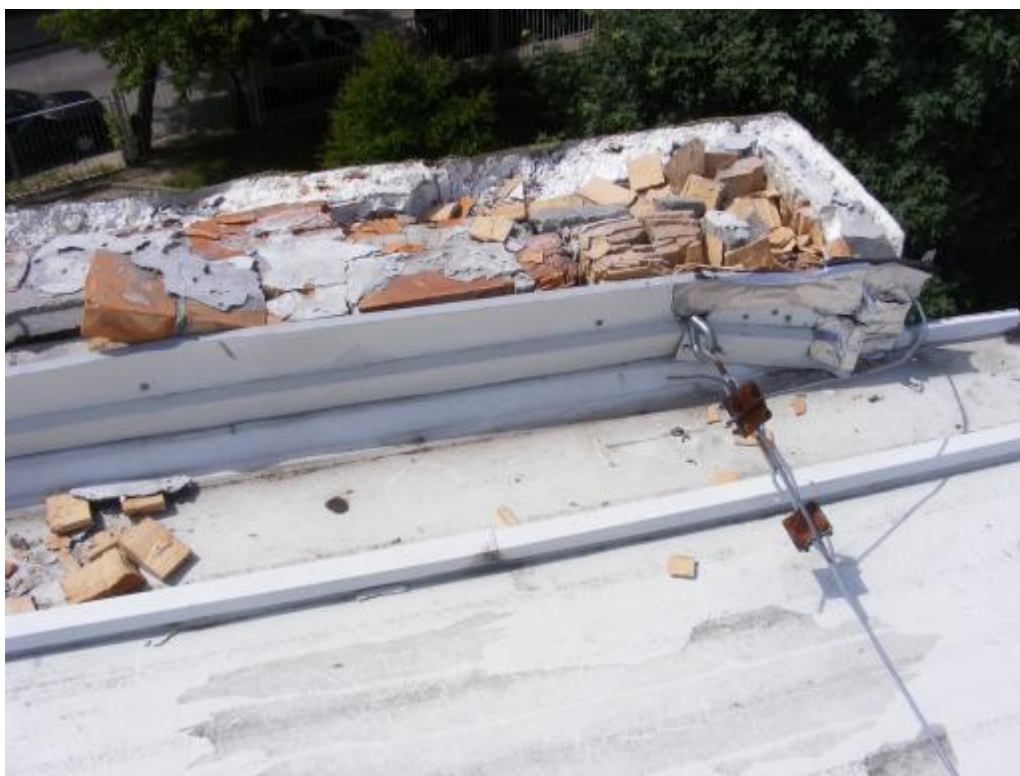
Fot. 7 Zerwana obróbka blacharska oraz skorodowane elementy murowe
