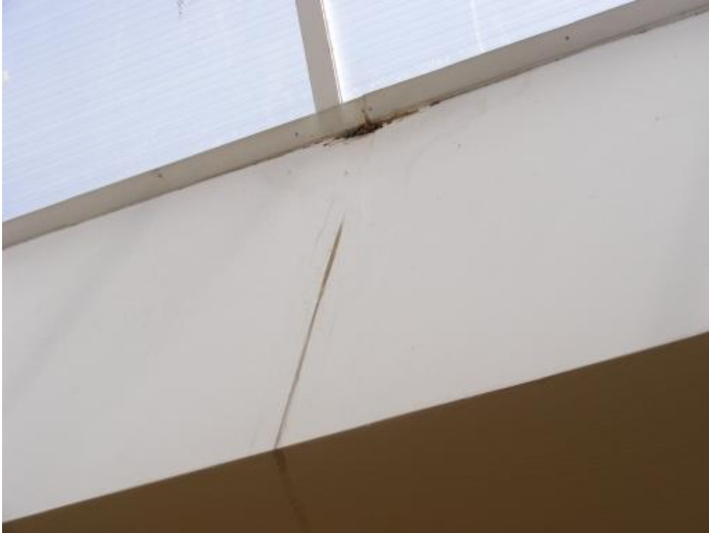
Fot. 10 Zawilgocenia w budynku dydaktycznym
