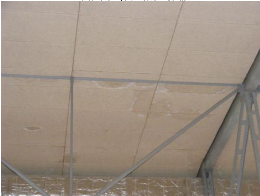
Fot. 4 Zawilgocenia wewnątrz sali gimnastycznej
