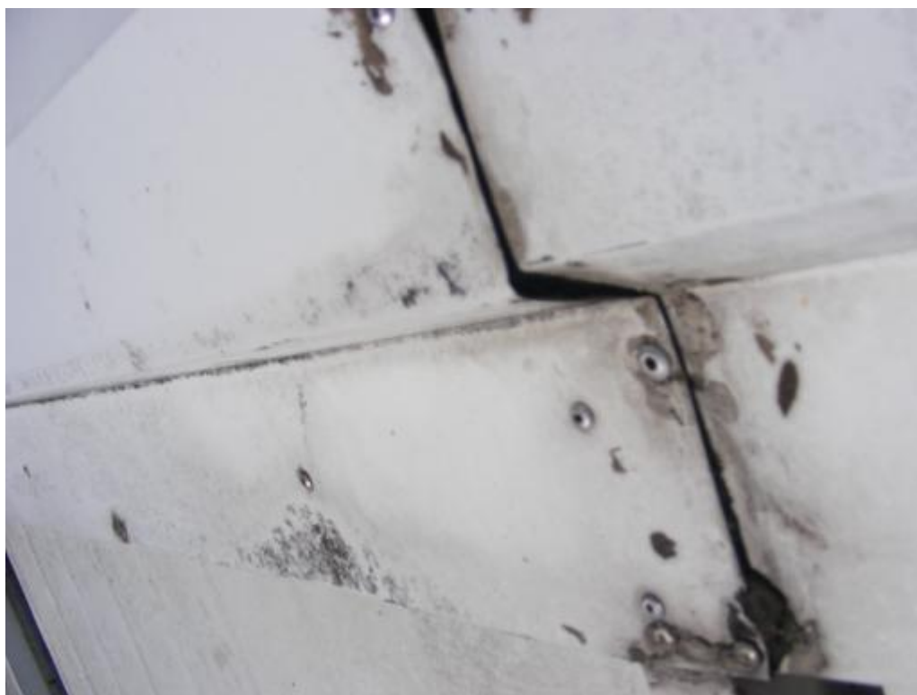
Fot. 3 Rozszczelniona obróbka kalenicowa
