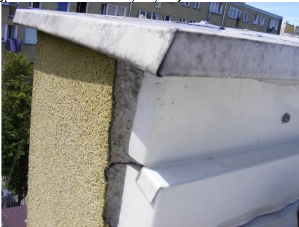
Fot. 6 Niewłaściwie wykonana obróbka ściany szczytowej
