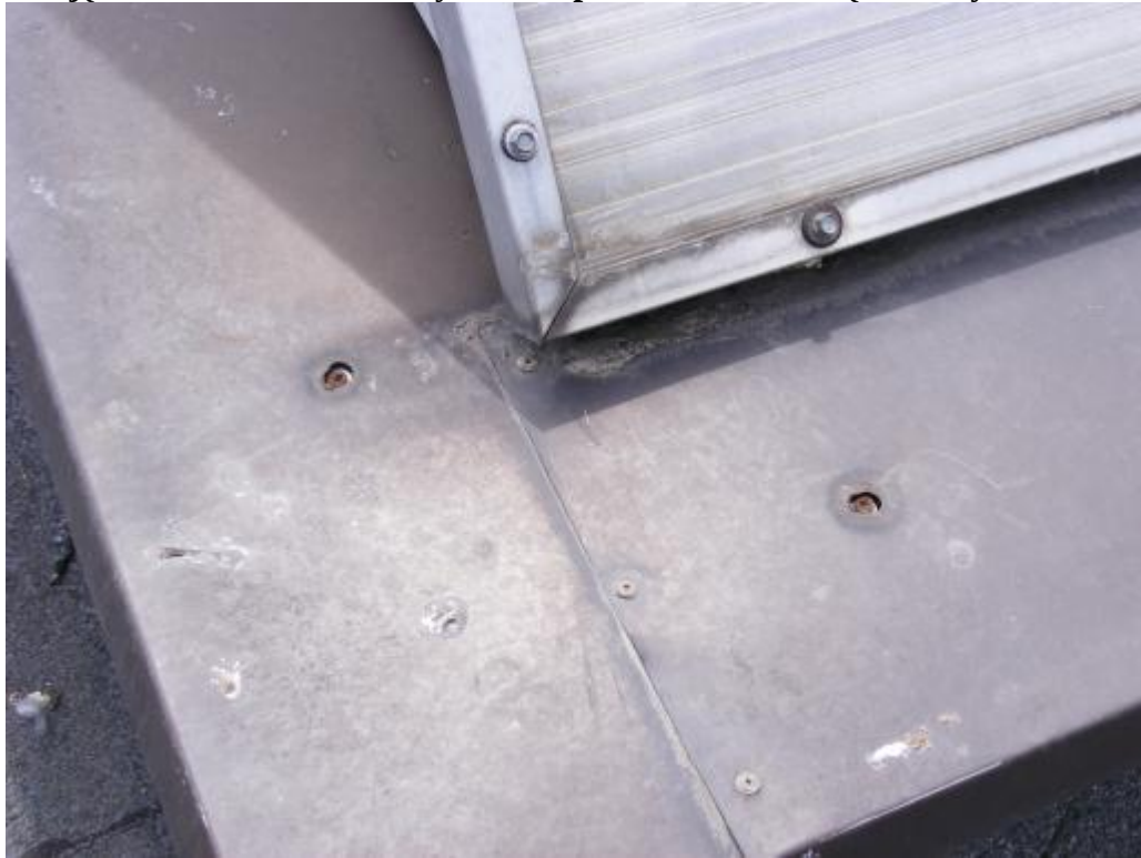
Fot. 8 Uszkodzona obróbka blacharska
