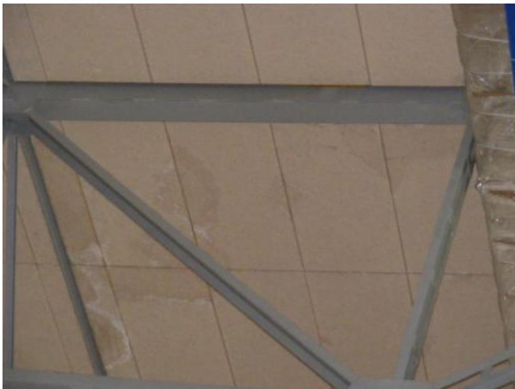
Fot. 5 Zawilgocenia wewnątrz sali gimnastycznej
