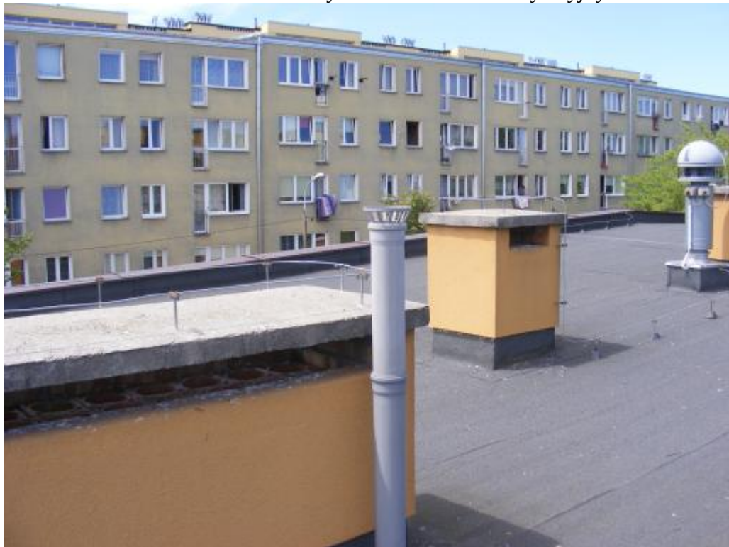
Fot. 12 Brak zakończenia wywiewki kanalizacyjnej
