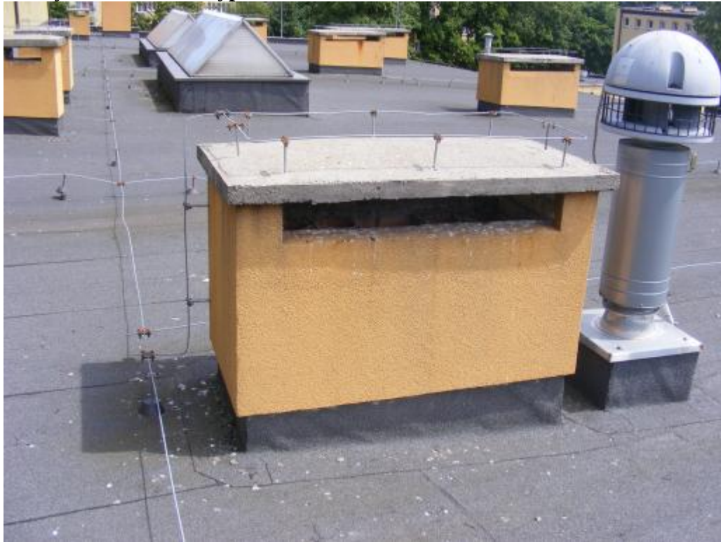
Fot. 11 Brak siatek ochronnych na kominach wentylacyjnych
