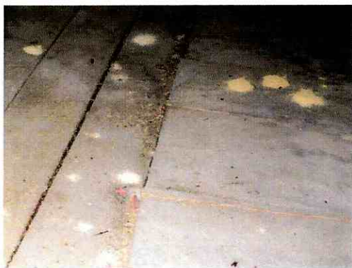
Fot. 4. Deski podłogowe wykazują ślady żerowania ksylofagicznych owadów.
