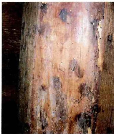
Fot. 11. W krokwi aktywne żerowisko spuszczela i kołatków.
