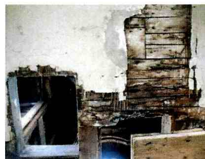
Fot. 13. Zniszczone deski podsufitki należy wymienić na nowe, impregnowane.
