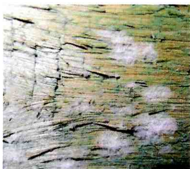
Fot. 8. Na drewnie impregnowanym Fobosem aktywny rozwój pleśni.
