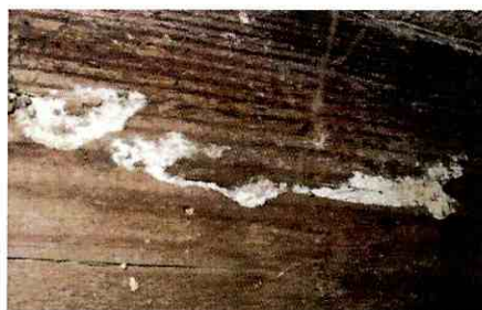
Fot. 7. W miejscu zacieku wodnego na krokwi grzyb – powłoczniczek gładki ( Cylindrobasidium laeve ).
