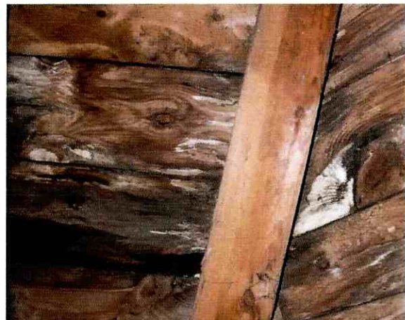
Fot. 12. W zawilgoconym deskowaniu połaci dachowej wieży aktywna forma rozwojowa grzyba domowego - jamkówki pogiętej (Antrodia sinuosa).
