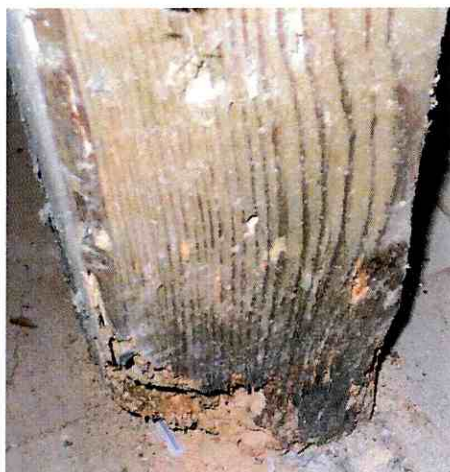
Fot. 3. Stolec mansardy północno – zachodniej części strychu ze zniszczeniami drewna przez spuszczała.
