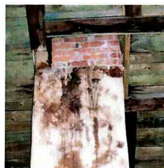
Fot. 10. Zacieki i ślady zawilgoceń na przewodzie kominowym.
