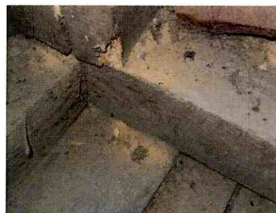
Fot. 6. Żerowiska spuszczela w tramach i stolcu więźby dachowej.
