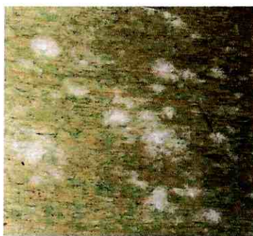
Fot. 9. Naloty pleśni na deskach poszycia w północno - wschodniej części strychu.
