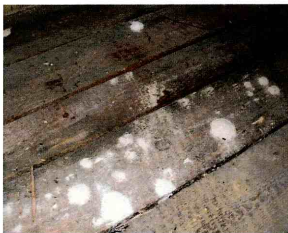
Fot. 2. W podłodze drewnianego stropu aktywne żerowanie larw owadów spuszcza.
